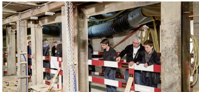
Ein Ort, der sonst verwehrt bleibt: Die unterirdische Baustelle im ehemaligen Poststollen unter dem PostParc stiess auf grosses Interesse.
